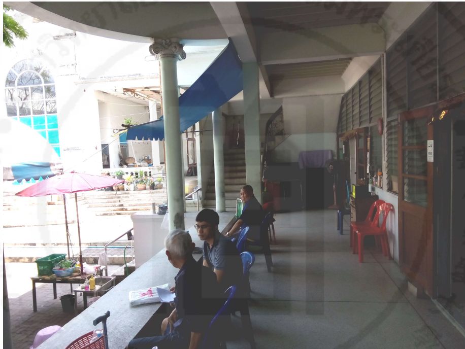
ภาพที่ 7 บันไดที่ไม่ใช่บันไดหนีไฟอาคารสถานสงเคราะห์คนชราเอกชนแห่งหนึ่งในจังหวัดสมุทรปราการ
